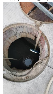
事故应急池（排空演练）
