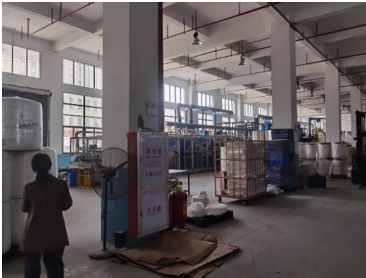
消防栓及自动喷淋系统
